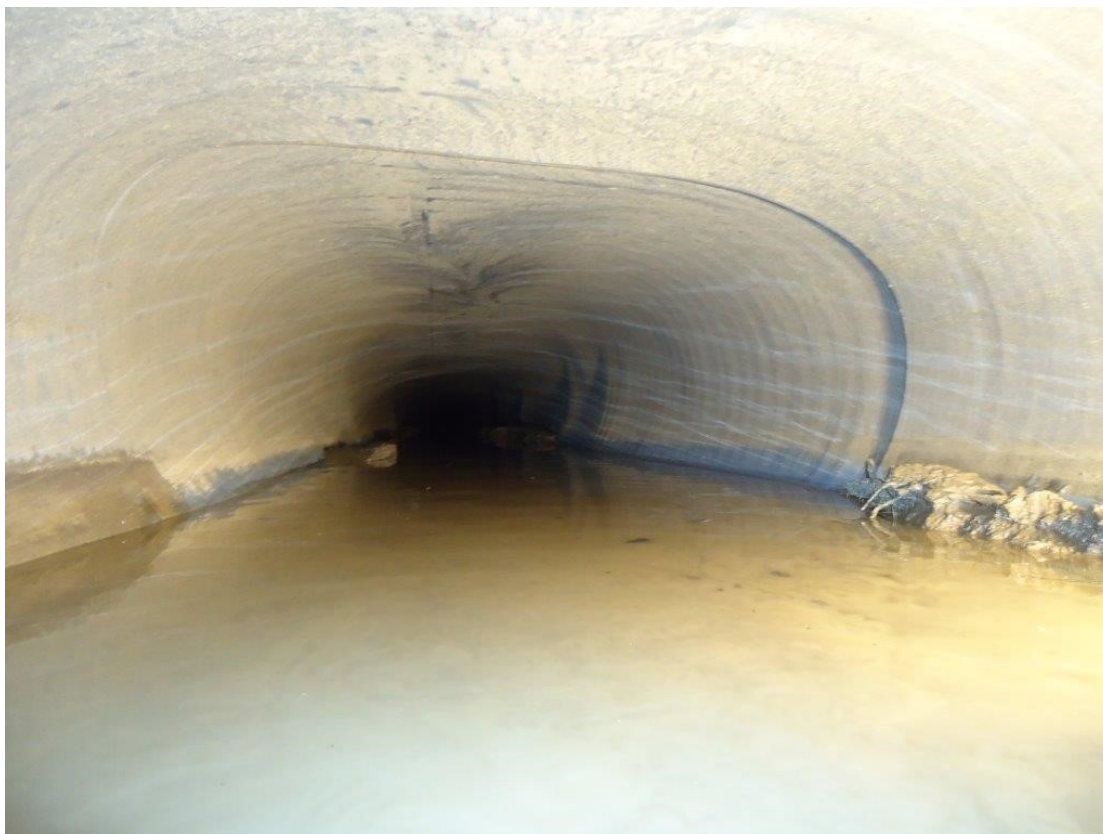
Slika 6-4 Prikaz vertikalne deformacije i puknuća cijevi
